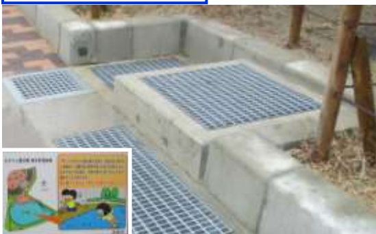
【公園貯留】 もすりん公園(尼崎市)
