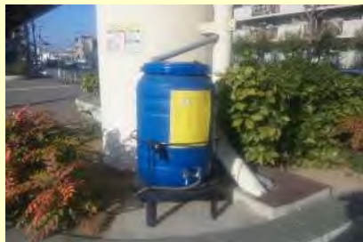
雨水貯留タンク(川西市)
