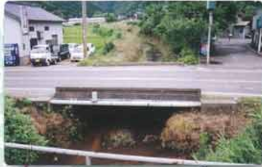
・改修が必要な橋ノ内橋 (国道178号)
