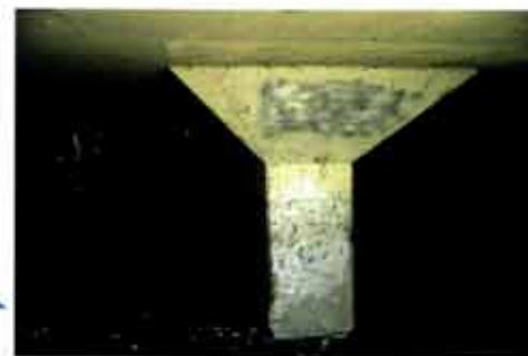
雨水は最初に地下貯留槽に溜められる
