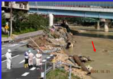
生瀬橋 上流右岸 護岸決壊(神戸市水道管流失)
