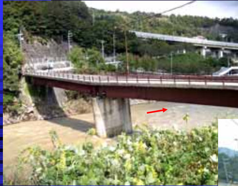
橋脚が傾く森興橋の全景
