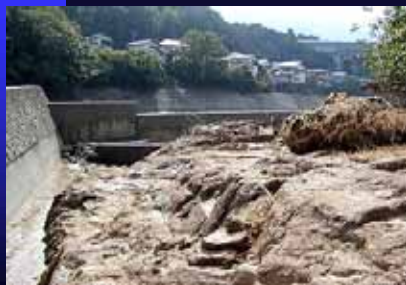
上流部の溢水箇所
