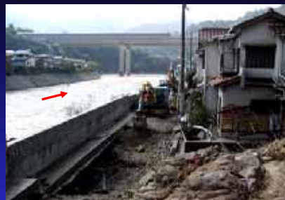
上流の溢水箇所から下流側
