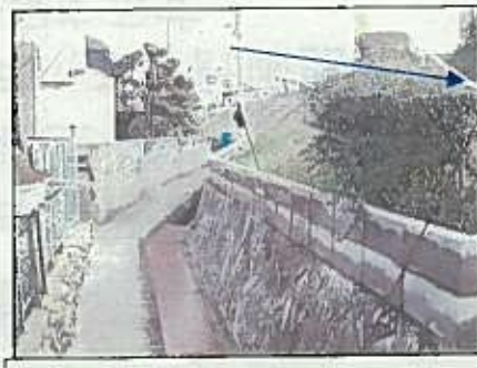
漏水の通報があった箇所近傍では、背後に民地が迫っている
