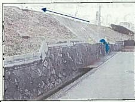
ブロック張工が施されている箇所付近が、法勾配が最もきつくなっている。
