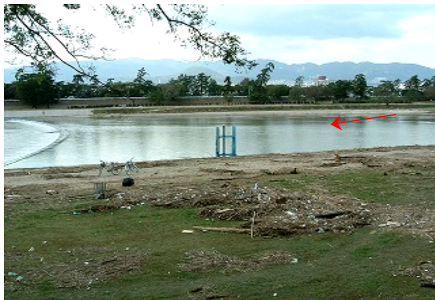
図 4-3 平成 16 年台風 23 号後の甲武橋下流（NO.77 左岸）の状況
