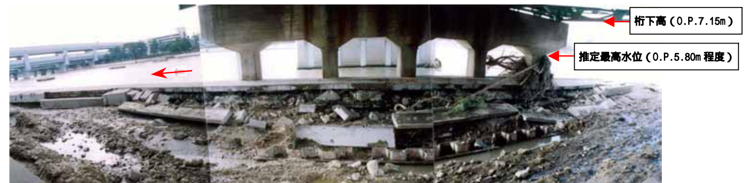
図 4-5 平成 16 年台風 23 号後の阪神電鉄橋梁の状況（草薙委員提供）
