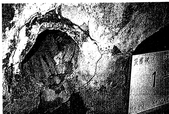
川西市 ヒューム管破損
