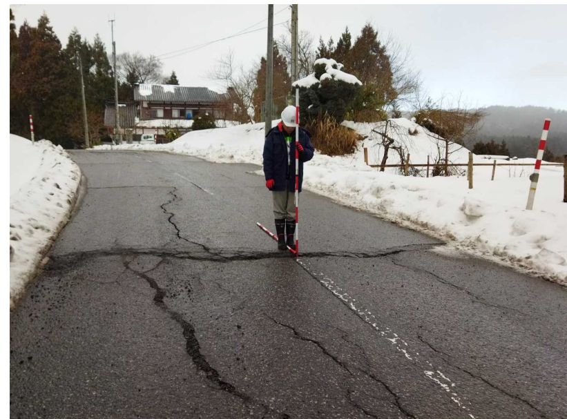
【市道被害状況調査(珠洲市) 1/28】
