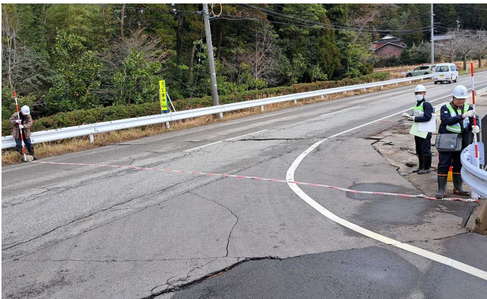
【珠洲市内の市道被害状況調査 1/21】
