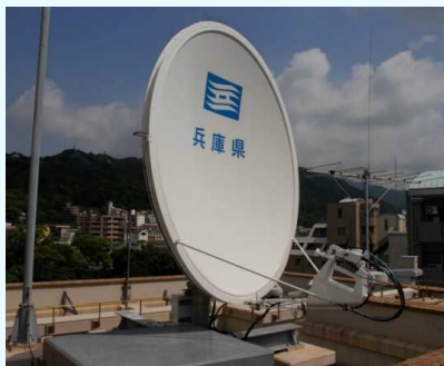
▲衛星アンテナ (災対センター屋上)
