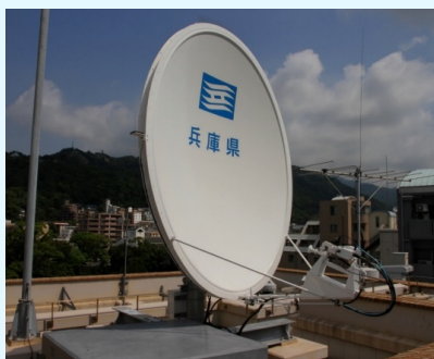
▲衛星アンテナ (災対センター屋上)
