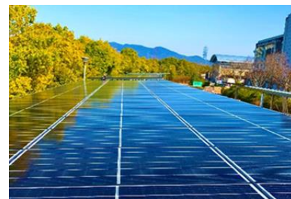
PPA方式での導入事例 (広域防災センター)
