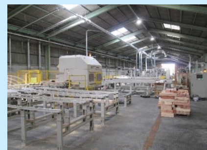
③生産性が向上したプレカット設備 （宍粟市）
