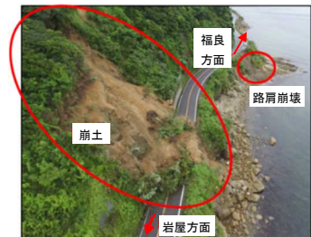
崩土・路肩崩壊の状況 県道福良江井岩屋線（淡路市）
