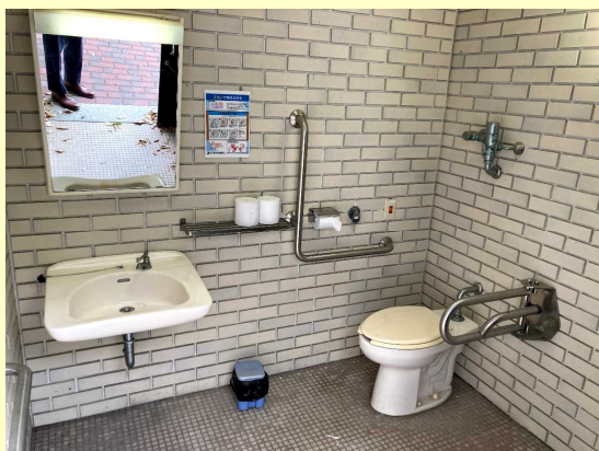
老朽化したトイレ
