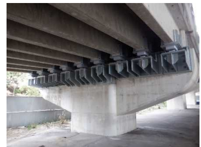
落橋防止装置・橋脚補強 県道芦屋鳴尾浜線 夙川橋（芦屋市）
