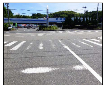
【摩耗した横断歩道】
