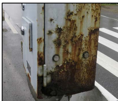
【腐食した信号制御機】
