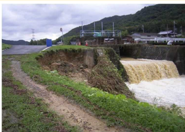
写真：菖蒲池下流の出水状況
