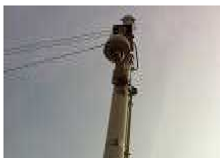
ため池の監視カメラの事例
