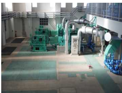
泊川（排水機場・水門機械設備）
