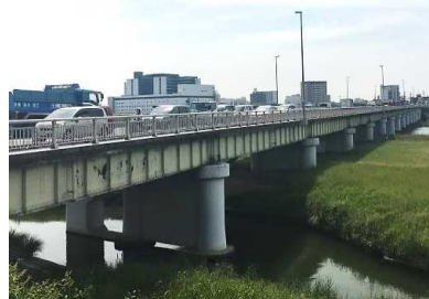
老朽化した橋梁（加古川橋）
