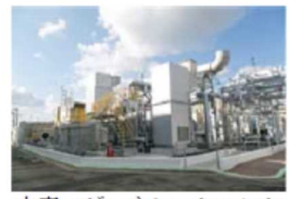
水素コージェネレーションシステムのプラント
