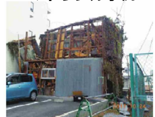
台風による空き家の倒壊(神戸市)
