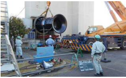
高砂市 天川ポンプ場 4.4 m 3 /sec × 2台(高砂市曾根町)
