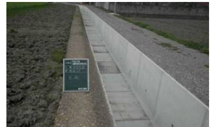
福崎町 川端雨水幹線 5.44 m 3 /sec(福崎町山崎地区)
