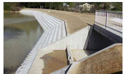
兵庫県 ため池事前放流設備 (姫路市夢前町寺 大谷池)
