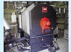
竹チップボイラー
