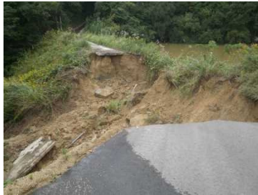
ため池堤体後法の被災
