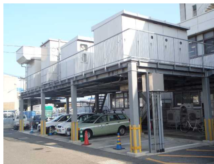
図 48 淡路県民局の自家発電設備の高層階設置
