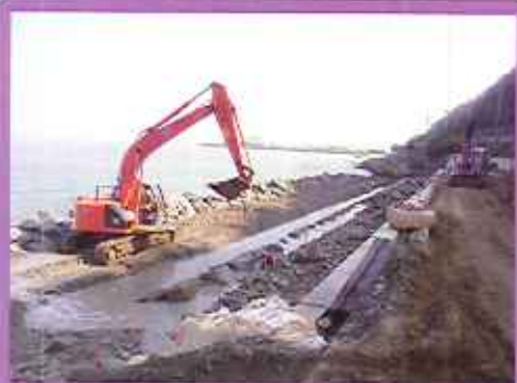
西淡海岸護岸補修工事 （南あわじ市湊登立） 大波による侵食を防ぎ、背後の土地を守るため、老朽化した護岸を補修する工事を行っています。
