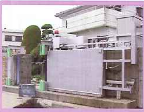
福良港陸間電動化工事 （南あわじ市福良） 高潮、津波による浸水被害を防ぐ目的として護岸を整備しますが、船の利用者には不便なため、人や車が入り出できる扉を設置しています。この扉を陸間（りっこう）といいます。陸間は人間の力で操作していましたが、電気で作動するモーターを取り付けることで安全かつ迅速に開閉することができます。
