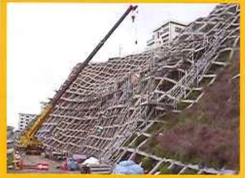
急傾斜地崩壊対策事業（鶴崎地区） 斜面に金網型沖と鉄筋を組み立て、コンクリートを吹き付ける工事です。斜面の崩壊から住民の生命を守るとともに災害時の避難場所である岩屋中学校を保全します。
