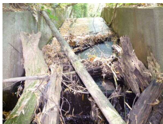
洪水吐を塞ぎ止めている流木
