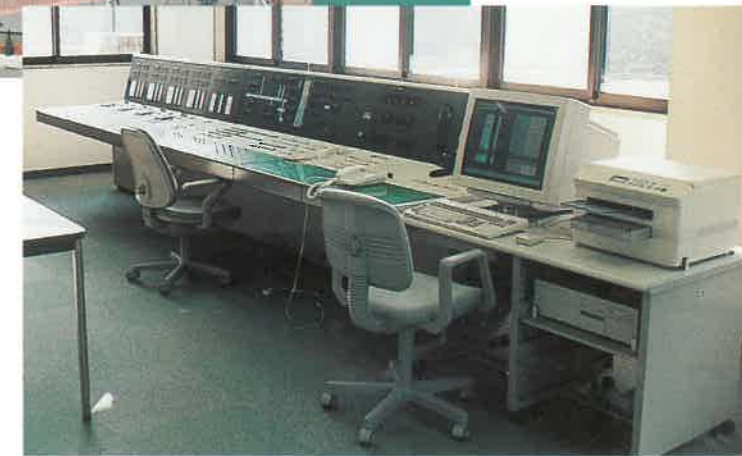
ダム管理所内のダム管理設備
