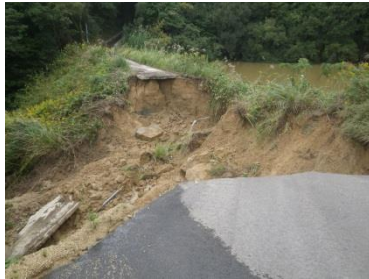
ため池堤体後法の被災
